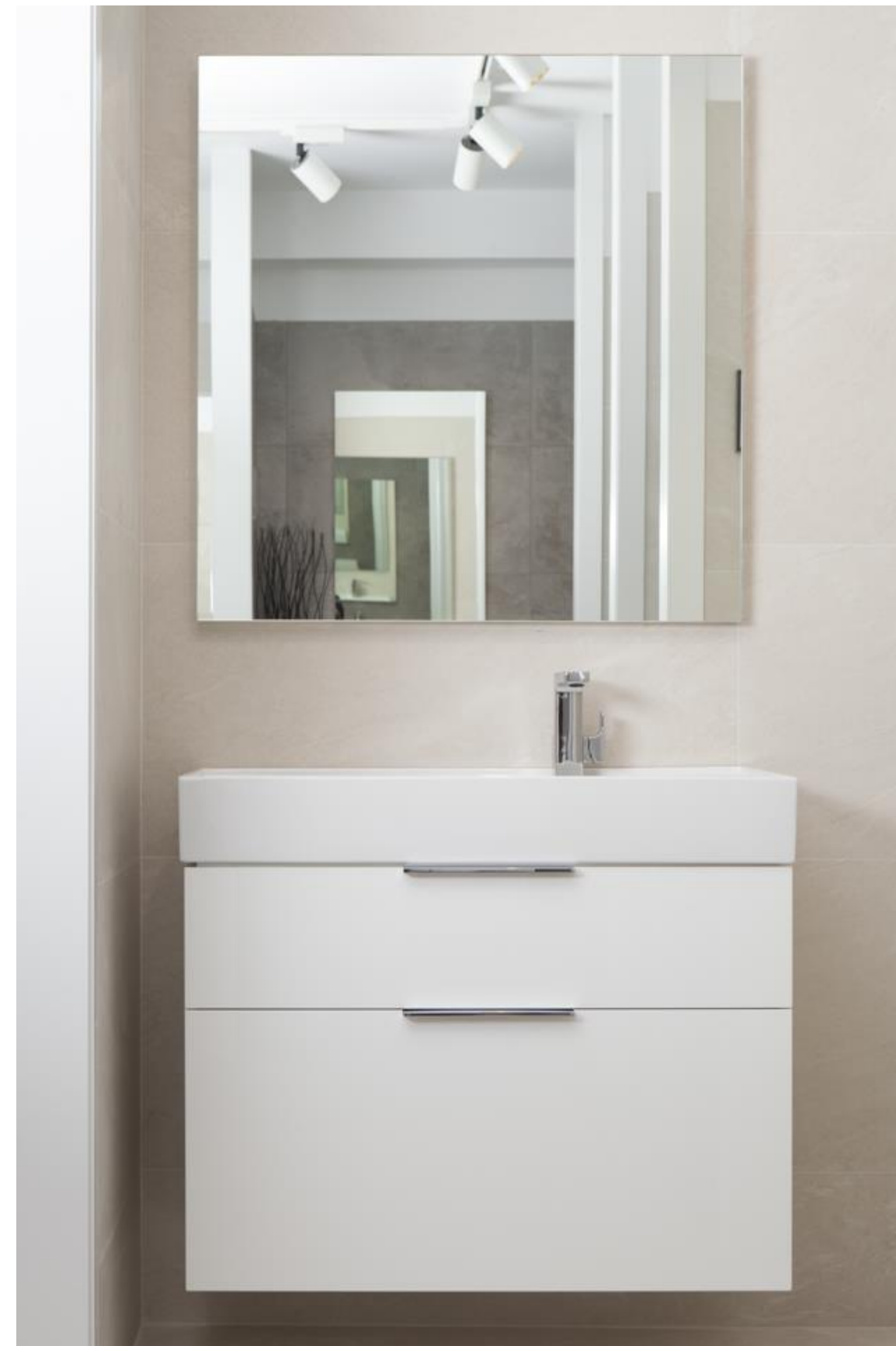
Mueble lacado en blanco con dos cajones con tiradores de acero inoxidable. Instalado bajo lavabo Kartell.
